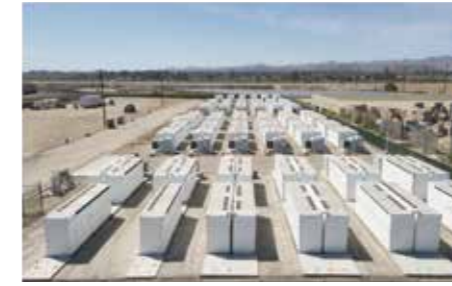
Resim-1: Tesla Megapack 100-MW/400-MWh Enerji Depolama Sistemi, Saticoy, Güney California (Resim: Arevon Asset Management)
